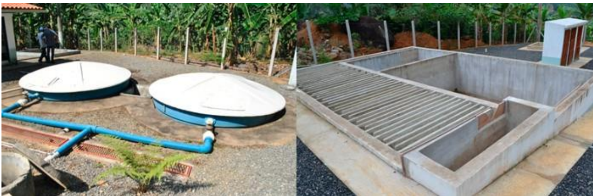
Figura 30 – Reservatórios ETA Sagrada Família (Reservatórios 20 m 3 )
