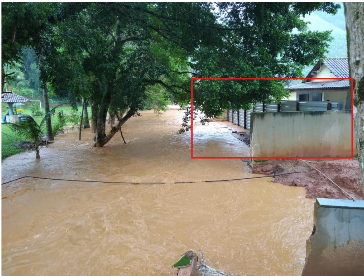
FOTO 1: Registro fotográfico das chuvas ocorridas em 2023. Em destaque, observa-se o fechamento improvisado do muro com tapumes, medida adotada após os danos ocasionados pelas enchentes de 2020.
