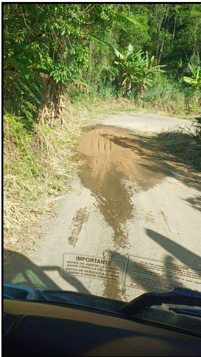
Fig. 03. Reparos com a mistura de material.
